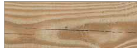
Trocknungsrisse (nach DIN zulässig)
