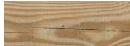
Trocknungsrisse (nach DIN zulässig)
